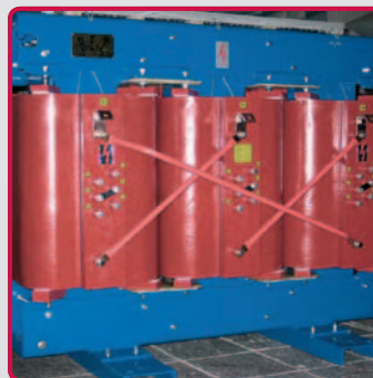
Amorfnní transformátory s extrémně redukovanými ztrátami
